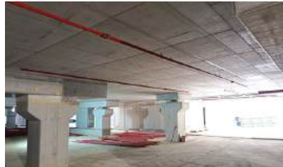
Autorimessa -1 impianto sprinkler / Garage -1 sprinkler system
