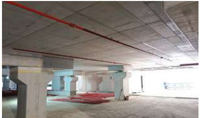
Autorimessa -1 impianto sprinkler / Garage -1 sprinkler system
